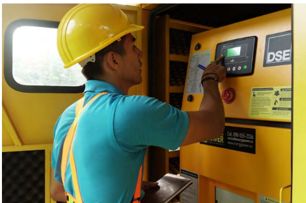
Transformador y generador. Fuente: Dirección de Recursos Físicos.
